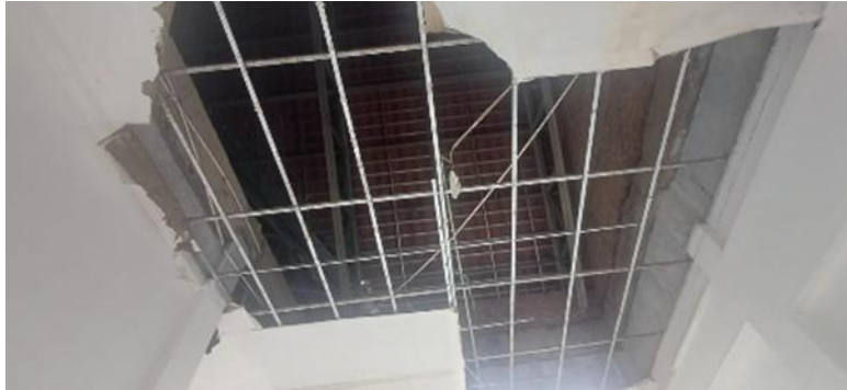
Gambar 2. 33 Joint Inspection pasca ambrolnya plafon Stasiun Sumobito
